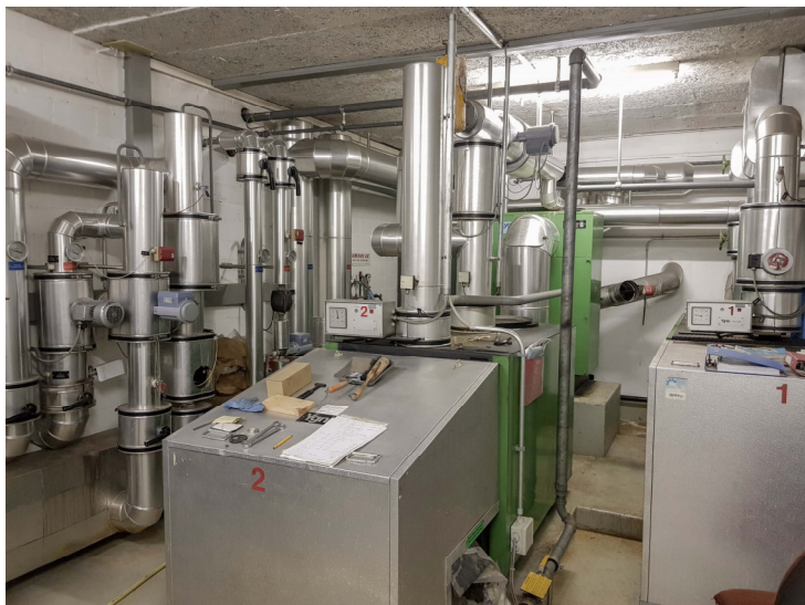
Abb. 62: Heizungsraum Bestand im 1. UG
