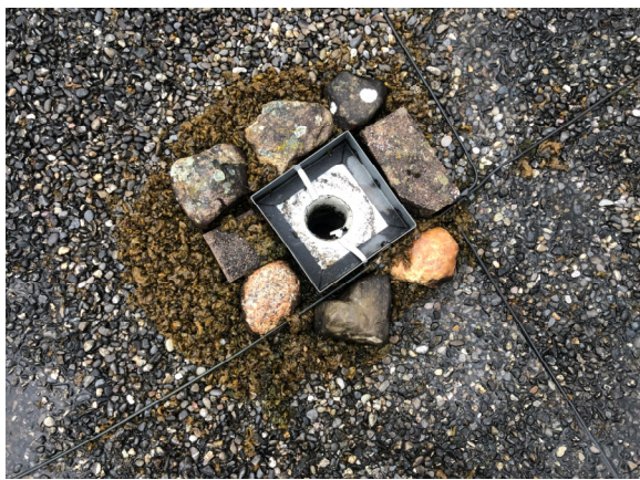
Abb. 33: Die Abläufe für die Dachentwässerung sind bereits stark verwittert.
