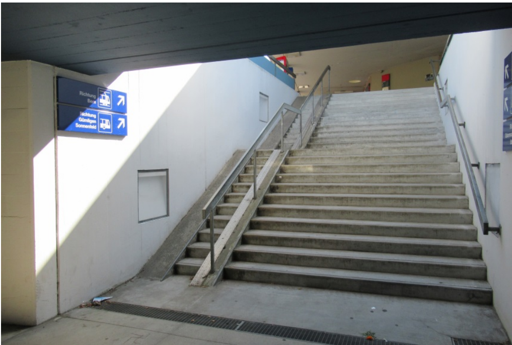
Abbildung 18: Zugang Haltestelle Melchenbühl in Fahrtrichtung Bern ist heute nicht hindernisfrei.
